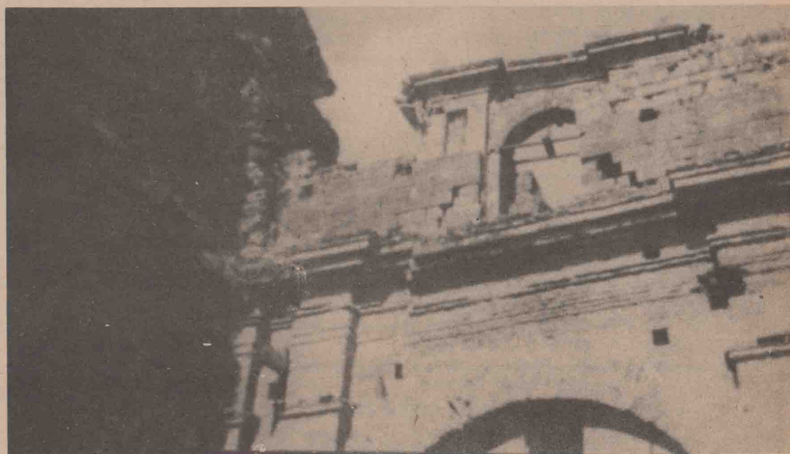
Detalhe das rachaduras em um dos paredões
